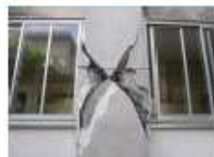
耐震化未完了の建物に 甚大な被害
